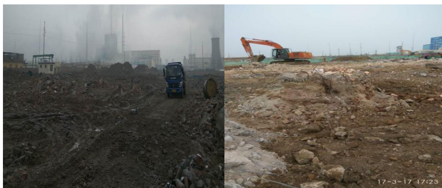
图 2.4-1 场地拆迁后地表建筑垃圾
